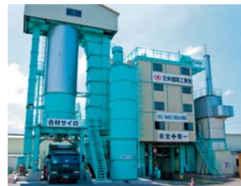
岩見沢市栗沢町にあるプラント。アスファルト合材など舗装資材を製造しています。
